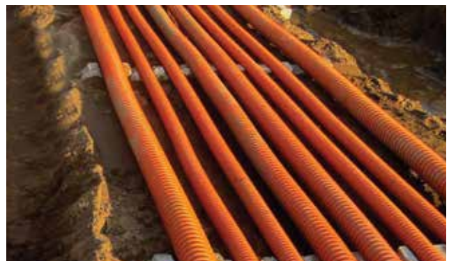
Công trình cáp ngầm nội đô thành phố. Underground cable application inside cities.
