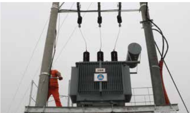
Công trình cáp nối trung, hạ thế. Cable connection application in low and medium voltage stations.
